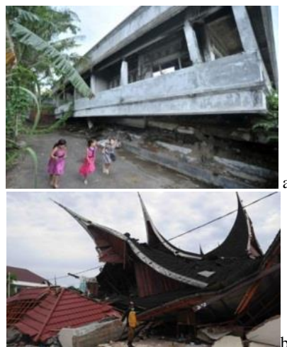
Gambar 8 : Dampak Gempa Besar tahun 2009 di Sumatra Barat terhadap Bangunan Gedung, tampak beberapa bangunan runtuh (Sumber : https://www.republika.co.id/berita/koran/kesra/16/03/06/nasional/darah/17/09/30/oxec1428-8-tahun-gempa-padang-belajar-dari-duka & https://nasional.tempo.co/read/346475/rekonstruksi-gempa-padang-butuh-rp-64-triliun )
