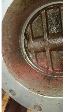
Gambar 9. Bagian Disc yang mengalami kebocoran
