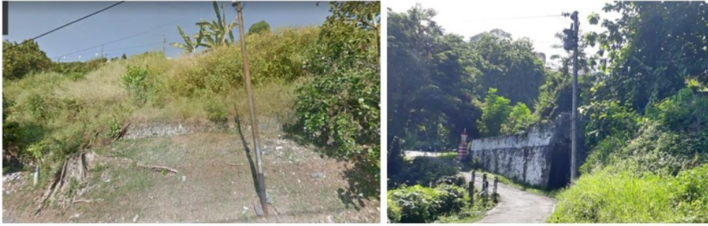
Gambar 2. Kondisi Lereng di Jalan Bukit Permata Raya
