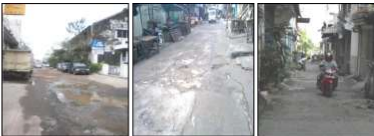
Gambar 3. 14 Kondisi Jalan Rusak
