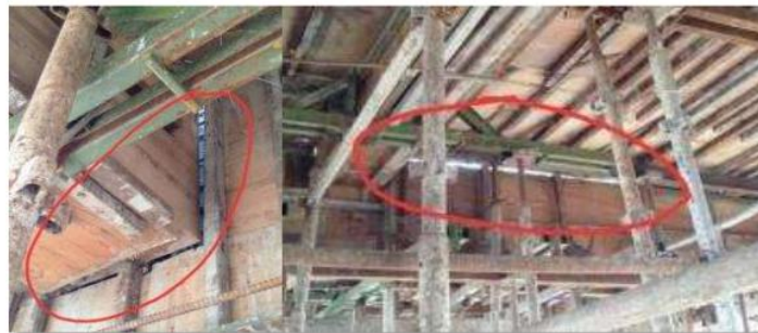
Gambar 5. Terdapat celah antar sambungan bekisting
