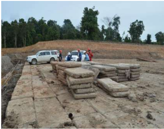
Gambar 1. Slab beton dengan kerusakan spalling
